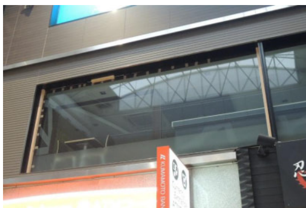
外押し縁が外れたのか？ ガムテープと木材で仮止めしている。
