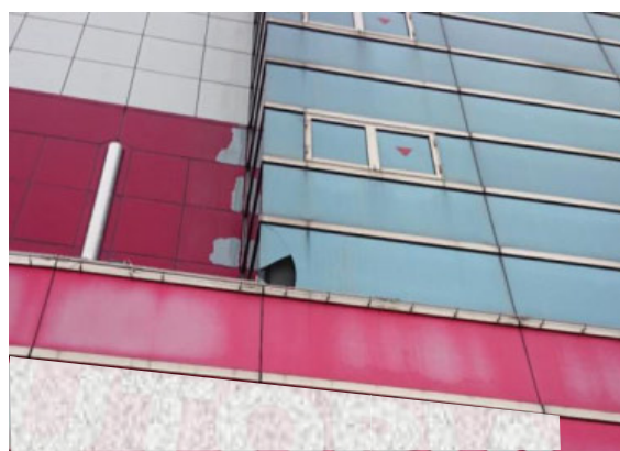
ガラス同士のコーナー突合せ部が 破損している
