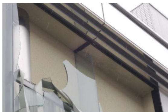
リブ上部にも破損が見られる
