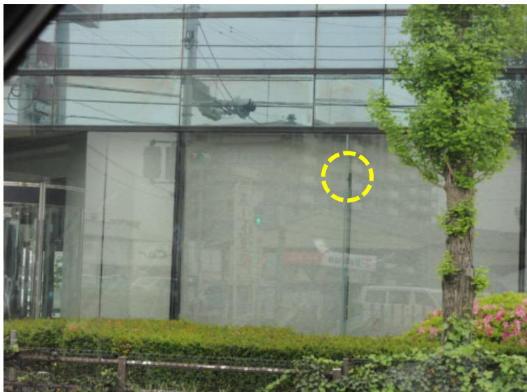
写真では分かりにくいですが、○部でリブガラスのS字変形と思われる破損が生じている
