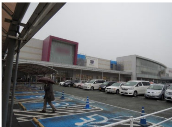
外装のガラスに破損は見受けられないが、ALC壁に損傷が見られる
