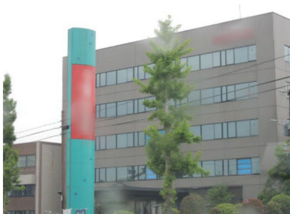
部分的にガラスが破損して、ブルーシートで 塞いでいる
