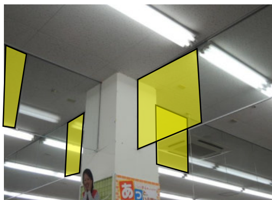
内部のガラス防煙垂れ壁 破損したと思われるガラスが取り外されている (黄色で色付けした部分)
