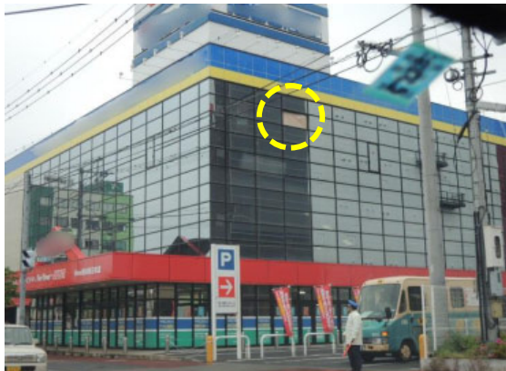
一枚だけ破損しているガラス 内部から何かが衝突した可能性が高い
