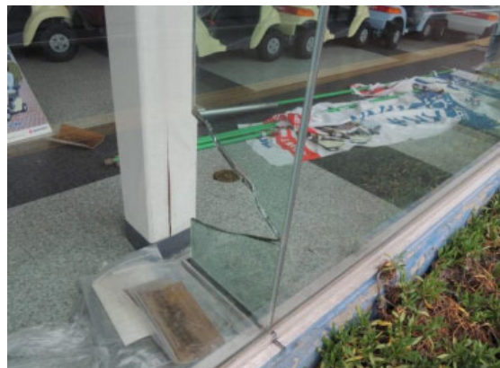
リブガラスのS字変形による割れ （左の写真を別角度から撮影）
