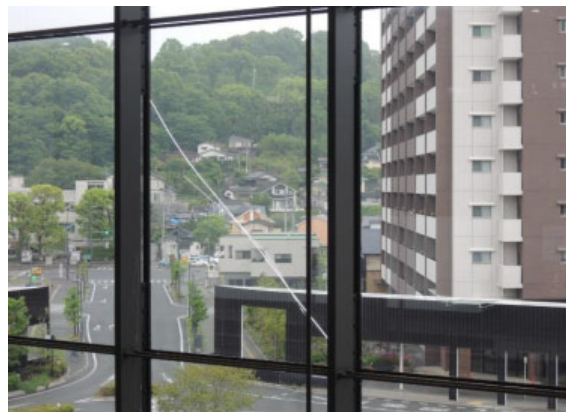
地震発生以前から割れていたと思われるガラス 地震の揺れでもサッシ枠から脱落していない
