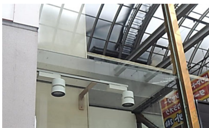
水平ガラスの角部に破損あり
