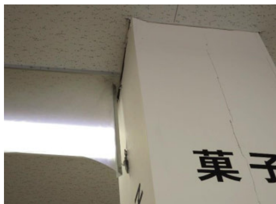
柱との間にすき間が生じている
