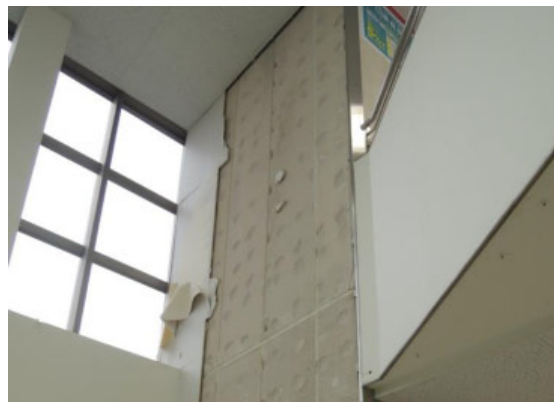
内装のボードが脱落している
