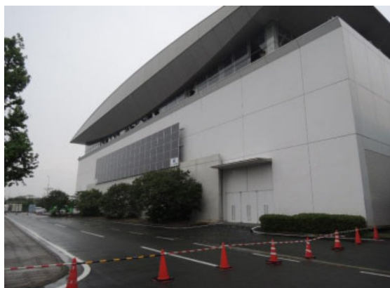
屋根の下部にある窓のガラスが破損している 破片が地上に落下したため、立入禁止にしている
