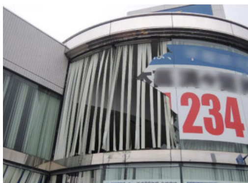
カッティングシート（広告）が貼られていたが、 飛散防止効果は無く、ガラスは脱落した
