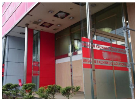
左の写真とは別の風除室も破壊されている 同じくリブガラスによるガラススクリーン構法
