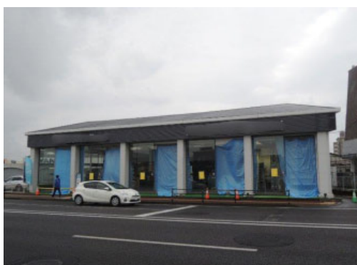
ガラスが破損したショールーム
