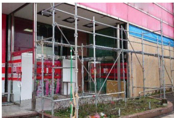
風除室と、その右側のガラススクリーンが 破壊されている
