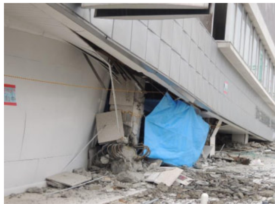
柱が圧壊している
