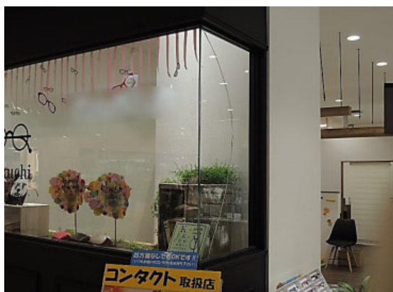
テナント店舗のショーケースに使用されている ガラス（側面）にひび割れが生じていた
