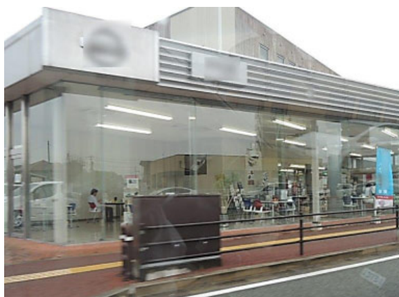
ガラススクリーン構法の破損無し
