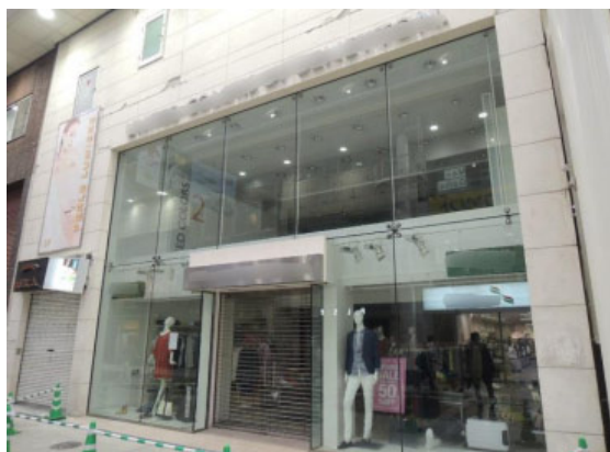
アーケード内店舗のDPG構法ガラススクリーン ガラスに破損は無いが、壁の損傷のため立入禁止
