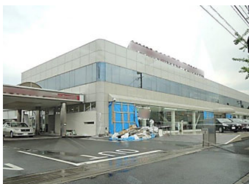
リブガラス構法によるガラススクリーンの 端部コーナー突合せ部のガラスが破損
