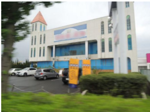
ガラスが破損したため、ブルーシートで 塞いでいる
