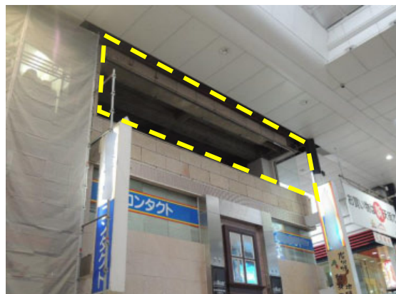
ガラスが破損したのか、開口部が空いている （横長のガラスが設置されていたのか？）
