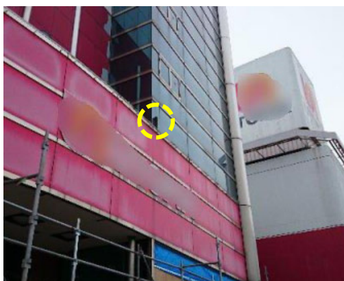
アルミカーテンウォール（バックマリオンタイプ） コーナー部のガラスが破損していた
