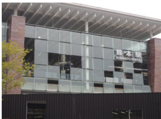
ガラスが破損・脱落したDPG構法CW（外観）
