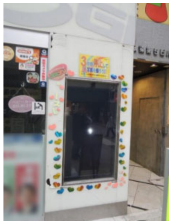
展示開口部周りのカラーガラスの破損 コーナー部で枠に当たって割れている
