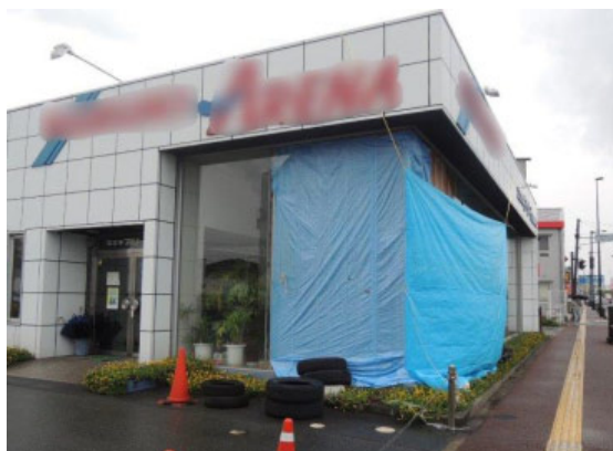
リブガラスを使用したガラススクリーン構法 90° 突合せコーナー部が破損している
