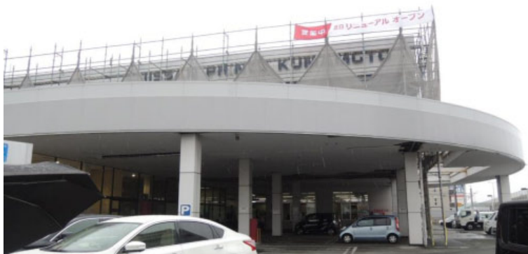
ピロティ部は、天井が脱落している
