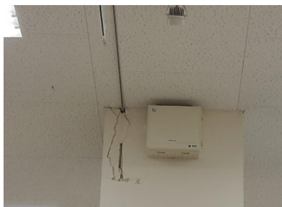
ガラス防煙垂れ壁が、柱にめり込んだ跡が確認できる（ガラスは撤去されている）
