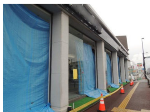
外側から見て右側のフェイスガラスのみが破損している
