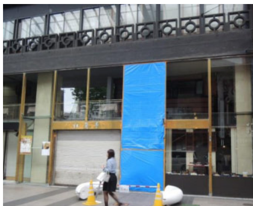
店舗のガラス破損
