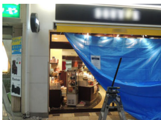
FIX部のガラス破損により、開口が生じたため、 営業できずにいる店舗
