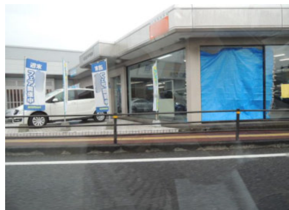
柱と取り合う端部のガラスにのみ、 破損が見られた
