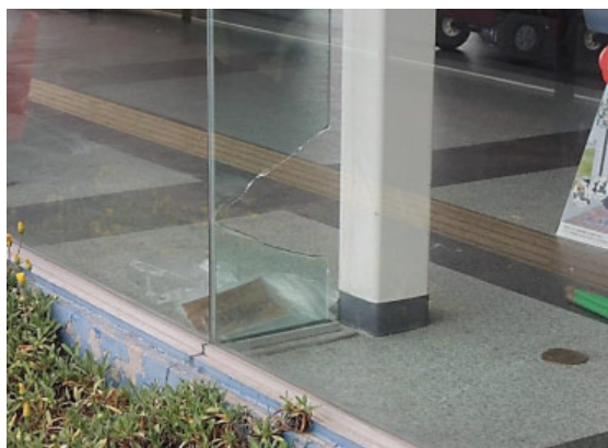
リブガラスのS字変形による割れ
