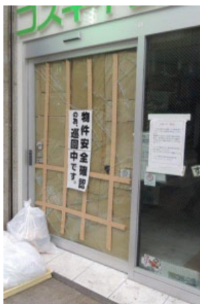
自動ドアの網入ガラスの破損 戸先のタッチスイッチ下が破損起点
