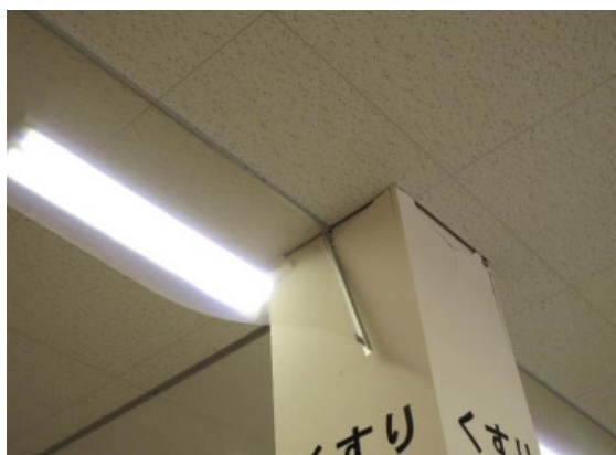
柱の揺れによって押し曲げられた 防煙垂れ壁のフレーム
