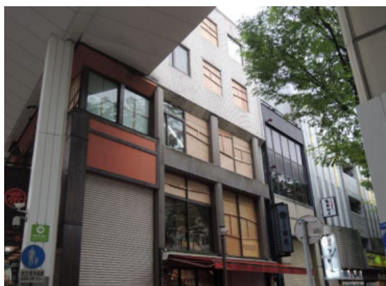
古い建物の開口部破損（ベニアで塞いでいる）
