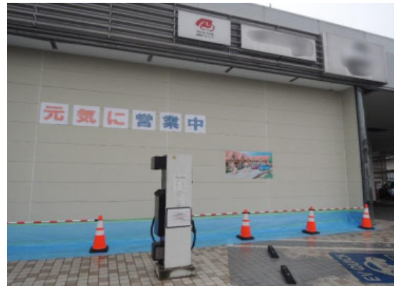
ガラススクリーン部をボードでふさいで応急処置 天井付近にリブガラスのサッシが見える
