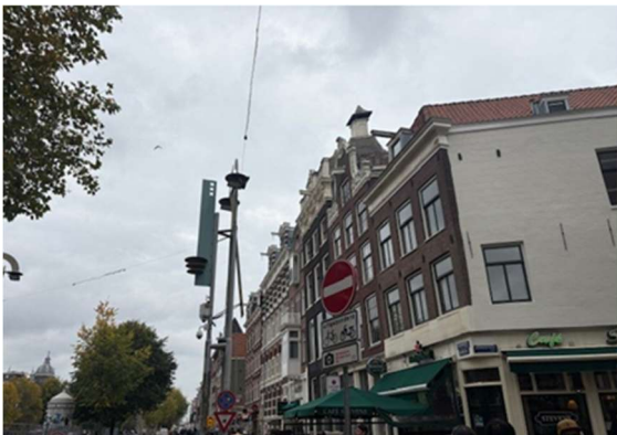
運河沿いの建築物 Façade が前面に傾斜
